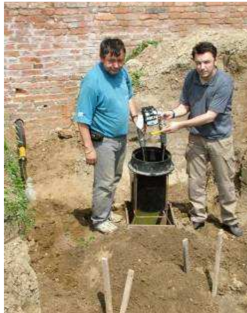
Forgódugattyús gázmérővel szerelt, földbe süllyesztett, vízelöntés ellen védett mérő állomás a Gyulai Vár kisnyomású gázbekötésénél. Az IP67 védettségű gázmérő elhelyezésének e rendhagyó módját –érthető okokból- a fokozott műemlékvédelmi követelmények indokolták.
