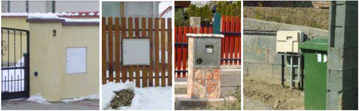
Telekhatáron, vagy telekhatáron belül, lehetőleg annak közelében elhelyezett házi gáznyomás-szabályozó és mérőállomások
